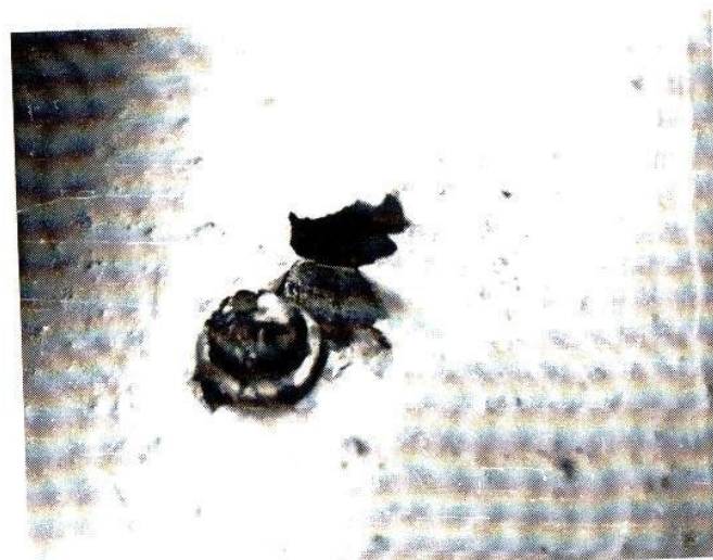
Рис.2. Разрушение краски в зоне болта снизу ортотропной плиты
