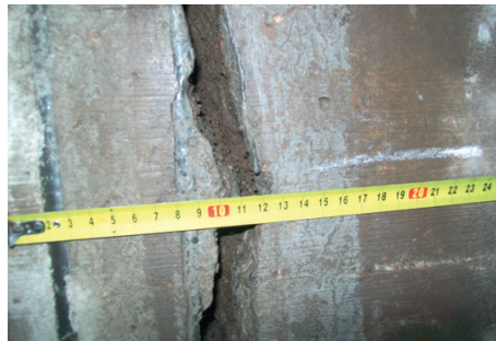
Размер раскрытия трещины № 2
