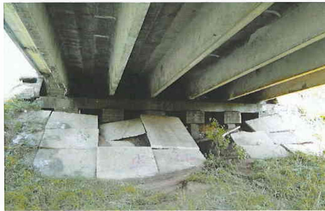
Фото 4. Вид снизу на пролетное строение до ремонта
